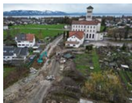
Hochwasserschutz beim Ruggbach (hier auf Höhe Forum Leiblachtal - ehemaliges Salvator Kolleg): Der Bach trennt und verbindet die Gemeinden Hörbranz und Lochau. Die Hochwasserschutzmaßnahmen beim Ruggbach werden ebenfalls gemeindeübergreifend bewerkstelligt.
