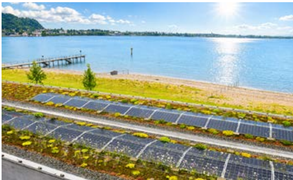
Auf dem Dach des Lochauer Strandbads befindet sich eine Photovoltaik-Anlage, die das Gebäude mit Strom versorgt. Die autarke Energieversorgung soll künftig als eigene EEG ausgebaut werden.
