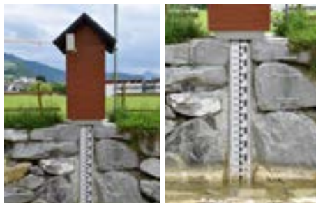
Der Sichtpegelmessger wurde erneuert und um ein digitales Ultraschall-Pegelmessgerät für das Hochwassermonitoring ergänzt.
