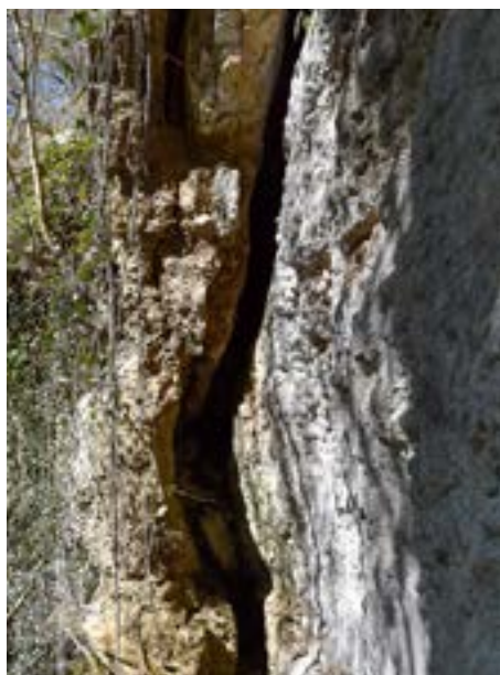
Der massive Riss im Fels stellt eine Gefährdung für den darunterliegenden Wanderweg dar.
