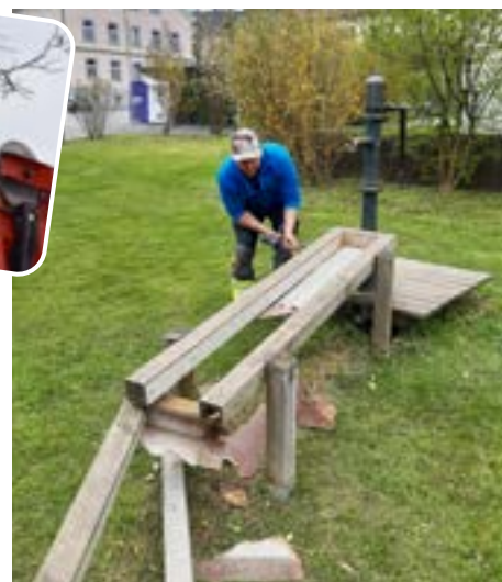
Reparaturen von Vandalismusschäden sind leider auch manchmal erforderlich..
