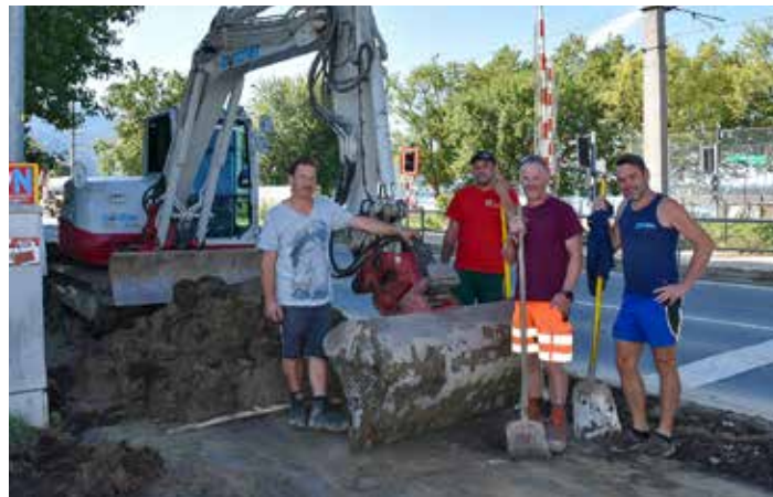
Nach dem Unwetter mit Hochwasser: Mitarbeiter des Wirtschaftshofs beseitigten den angeschwemmten Schlamm.
