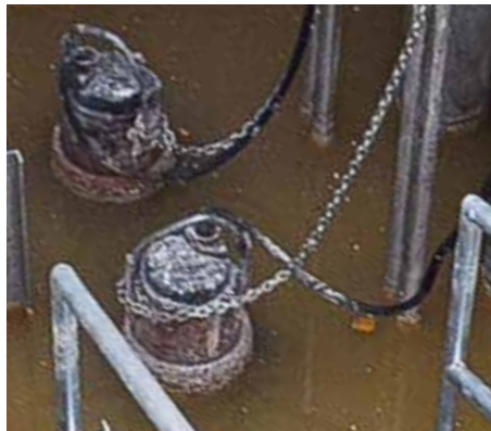
Die zwei Pumpen befördern das Abwasser zur Kläranlage
