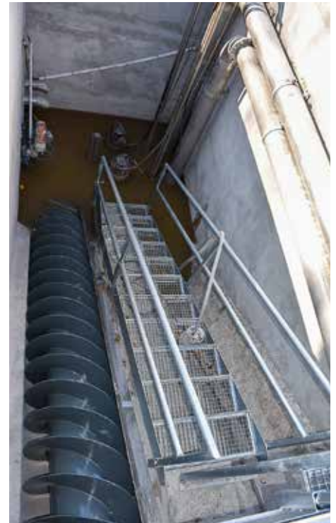
Bei einer Verstopfung der Pumpen kommt die „Schnecke“ zum Einsatz
